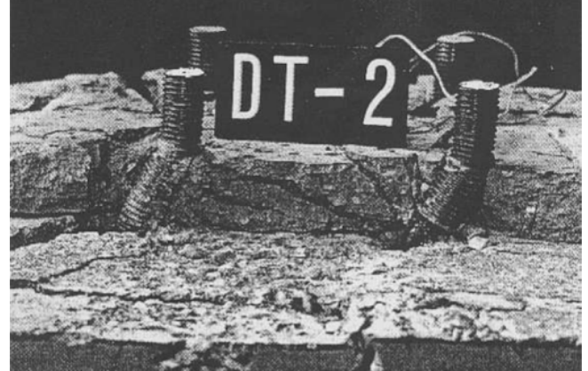
FIGURE 7.24 – Ruine de tiges d'ancrage due au cisaillement
